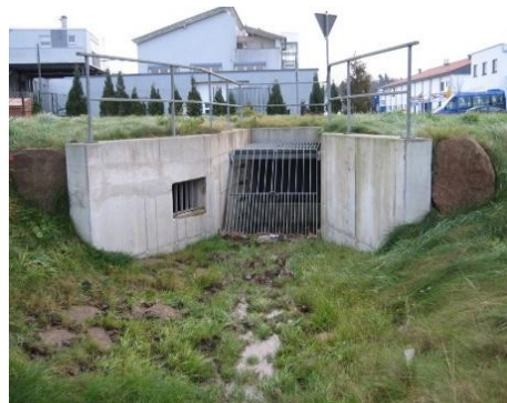
Beispiel großzügig dimensioniertes Einlaufbauwerk, Stadt Karlsruhe
