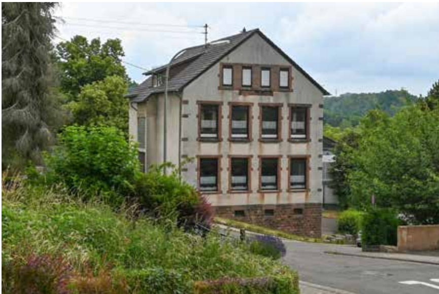
„Alte Schule“ mit Sanierungsbedarf, Schulstraße
